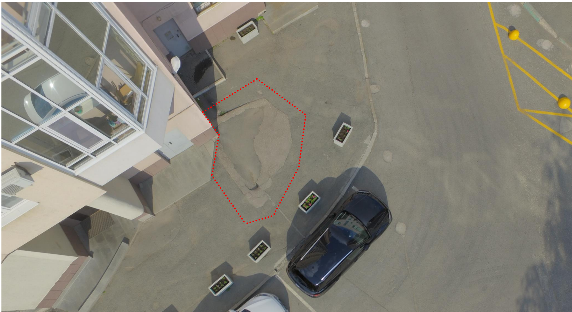
1 подъезд, участок справа от входа, площадь около 30 кв.м.
