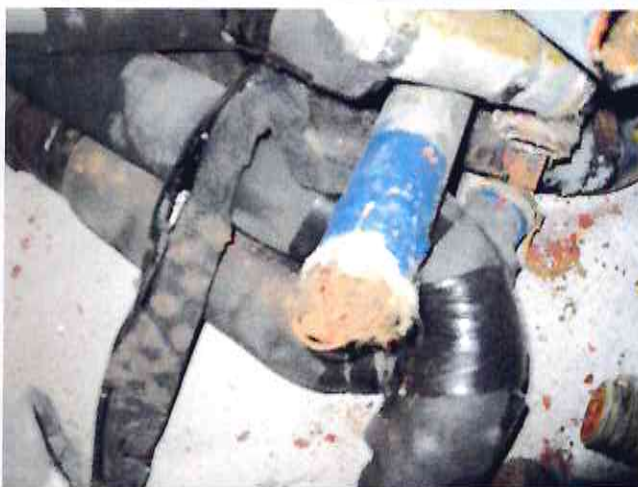
ФОТО №7 (срезанный кусок стояка ГВС, свищи, зарос отложениями из-за отсутствия растворяющих известь и ржавчину присадок в воде)
