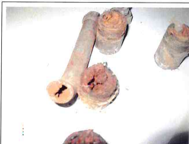
ФОТО №2 (срезанные отводы, заросли отложениями из-за отсутствия растворяющих известь и ржавчину присадок в воде)
