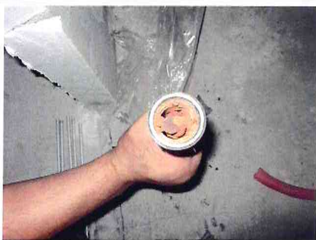
ФОТО №6 (срезанный кусок стояка ГВС, свищи, зарос отложениями из-за отсутствия растворяющих известь и ржавчину присадок в воде)
